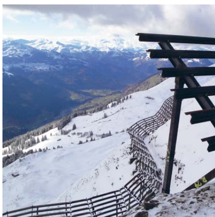
Lawinerverbauung Galmun, Saas i. P. (Foto: tur gmbh)
