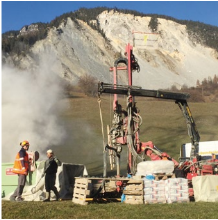
Bohrung unterhalb Brienz im Rahmen der Voruntersuchung. Die Bohrung wurde zur Erkundung tiefer Gleitflächen mit Glasfaserkabel ausgerüstet. Im Hintergrund ist das Felssturzgebiet sichtbar. (Foto AWN)
