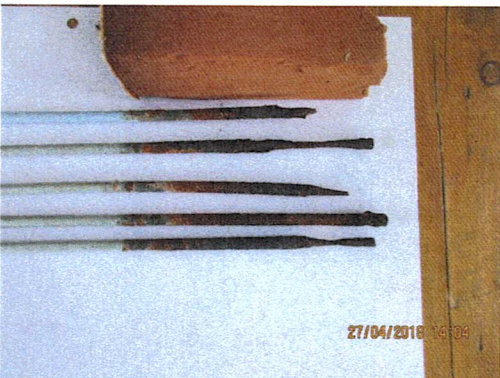
e) Korrosionsschädigung von Befestigungen im Durchstossungsbereich mit der Innenisolation
