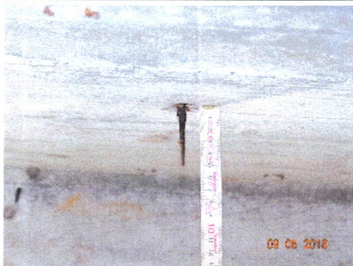
f) Korrosionsschädigung von Befestigung (Innenisolation Hallendach demontiert)
