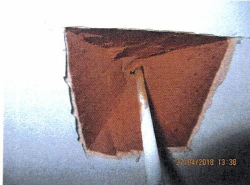
d) Inspektionsöffnung in der Innenisolation, Korrosionserscheinungen an der Befestigung
