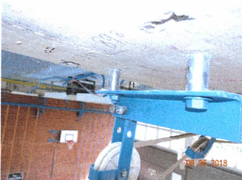
c) Komplett einsehbare Befestigungen/Verankerungen im Hallendach
