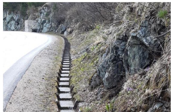
Abbildung 24: Beispielbild einer Ableitung aus Beton. Wildbachschalen am Albulapass.
