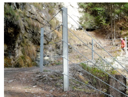
Absturzsicherung für Biker durch minimal 1.30 m hohen Zaun (Stahlprofilpfosten mit Drahtseilausfachung).
