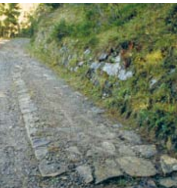
Dieser Karrweg mit Plattenpflaster wurde durch Aufschotterung zu einem Fahrweg verbreitert. Alpnach OW (ViaStoria/Guy Schneider).
