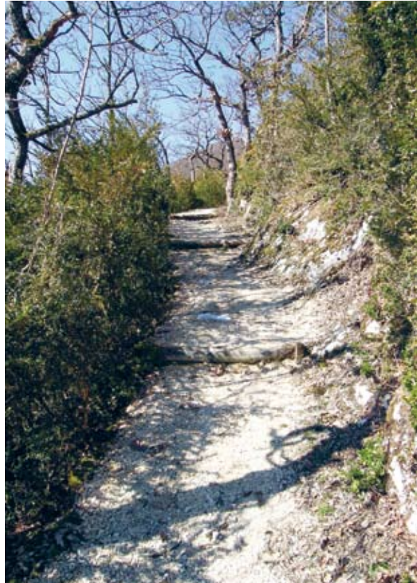
Schotter: Ein charakteristischer touristischer Fussweg mit Jurakalkschotterung im steilen, felsigen Gelände. Die «Jakobsleiter» bei Egerkingen SO (ViaStoria/Cornel Doswald). Vgl. S. 54.
