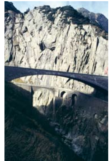
Entlastung durch Neubau: Die «Teufelsbrücke» der Gotthardstrasse von 1830 war dem Autoverkehr nicht gewachsen und wurde 1955/56 durch eine neue Strassenbrücke entlastet. Schöllenschlucht UR (ViaStoria/Cornel Doswald).
