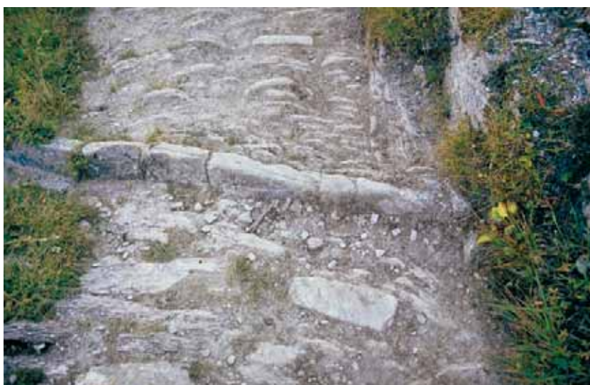
Canaletta trasversale di smaltimento delle acque, realizzata con lastre di pietra messe di taglio, sulla via d'alpeggio non carreggiabile di Bargis GR sul Flimserstein (Via-Storia/Arne Hegland).
