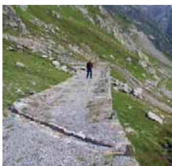
La canaletta trasversale in pietra inserita nella superficie viaria consente il passaggio dei veicoli. Antica strada del Passo del Susten UR (ViaStoria/Guy Schneider).
