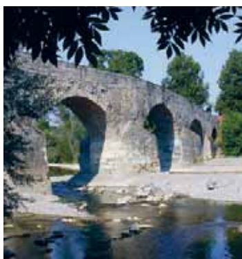
Riparazione e restrizioni d'uso. Il ponte tardomedievale sulla Thur a Bischofszell TG è stato restaurato nel 2000–2005 con consolidamento della muratura, impermeabilizzazione, drenaggio e posa di un rivestimento specifico sulla corsia pedonale (Andres Betschart).
