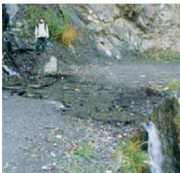
Guado in muratura nelle Alpi, con un alto muro di sostegno sul lato a valle, lungo l'antica strada della Binntal VS (ViaStoria/ Guy Schneider).
