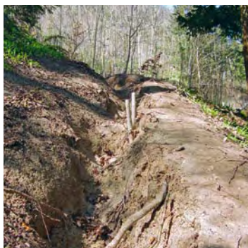
Fig. 91 Solco di erosione
