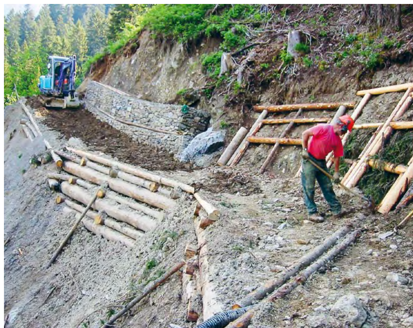
Fig. 81 Consolidamento della scarpata mediante palificate di sostegno (a sinistra), gabbioni (a monte) e grata di sostegno (a destra)
