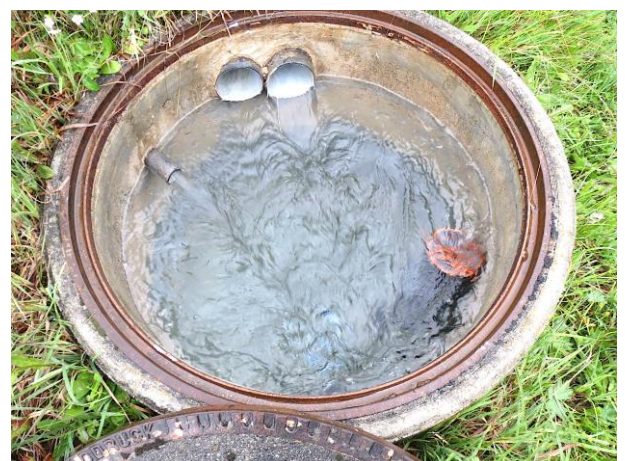
Bild: © ALT – mangelhafter Quellschacht
