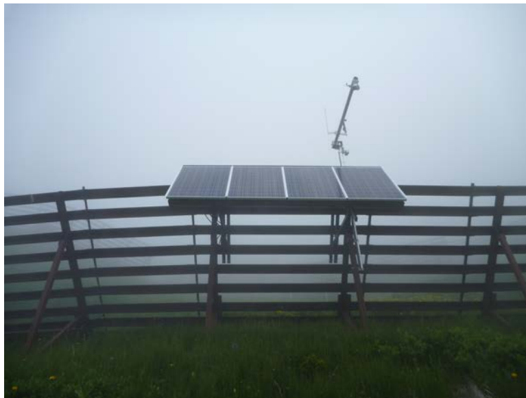
Abbildung 9-12: Photovoltaikanlage am Kühnihorn in Sankt Antönien
