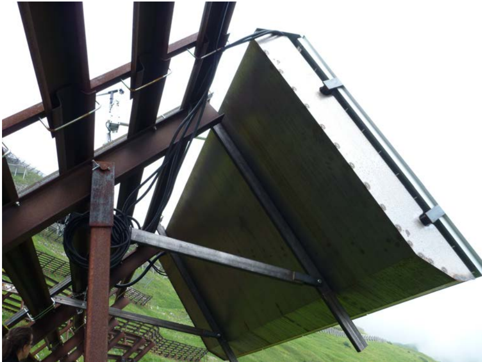
Abbildung 9-11: Tragkonstruktion der Photovoltaik-Pilotanlage Kühnihorn, Sankt Antönien. Die Solarmodule sind an den Trägern der Stützwerke der Lawinenverbauung befestigt
