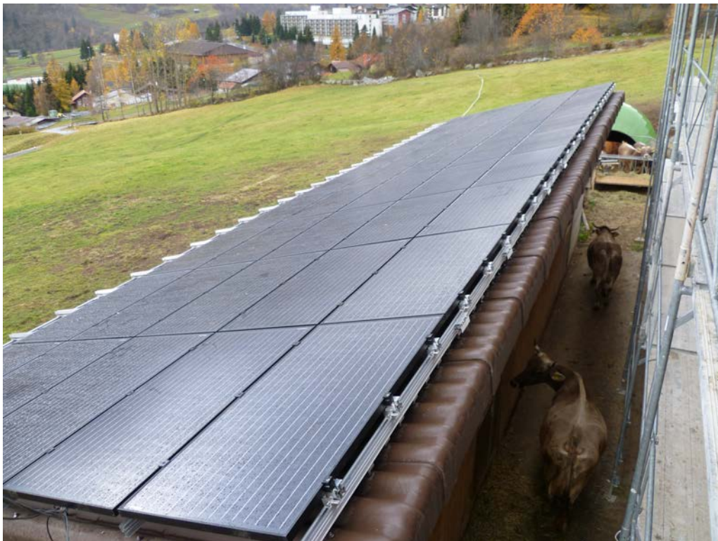
Abbildung 3-1: Stall in Disentis. Zwei Dächer. Installierte Leistung 30 Kilowatt-peak
