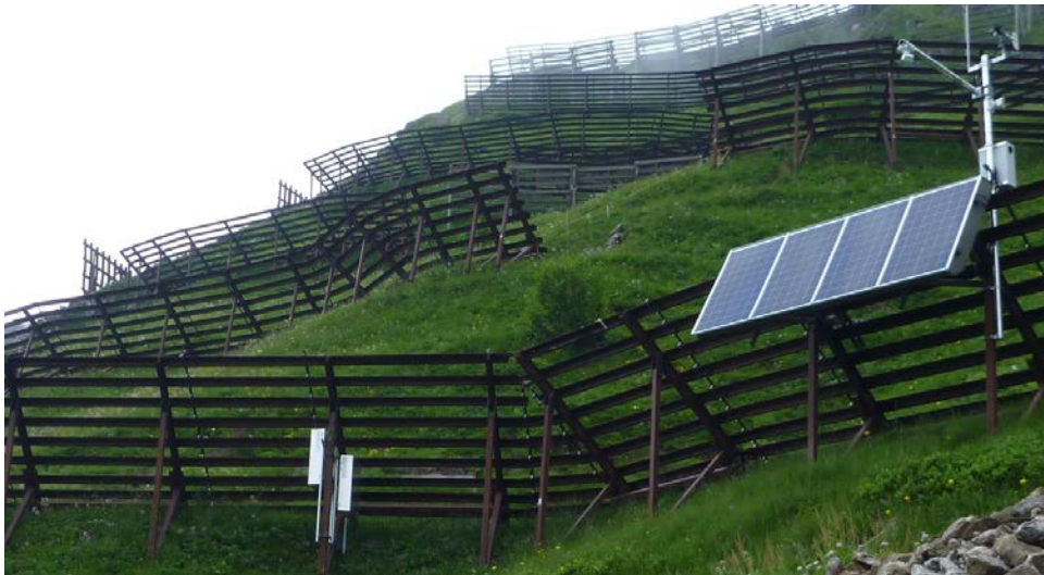
Abbildung 3-5: St. Antönien Lawinenverbauung am Kühnihorn. Photovoltaik-Pilotanlage
