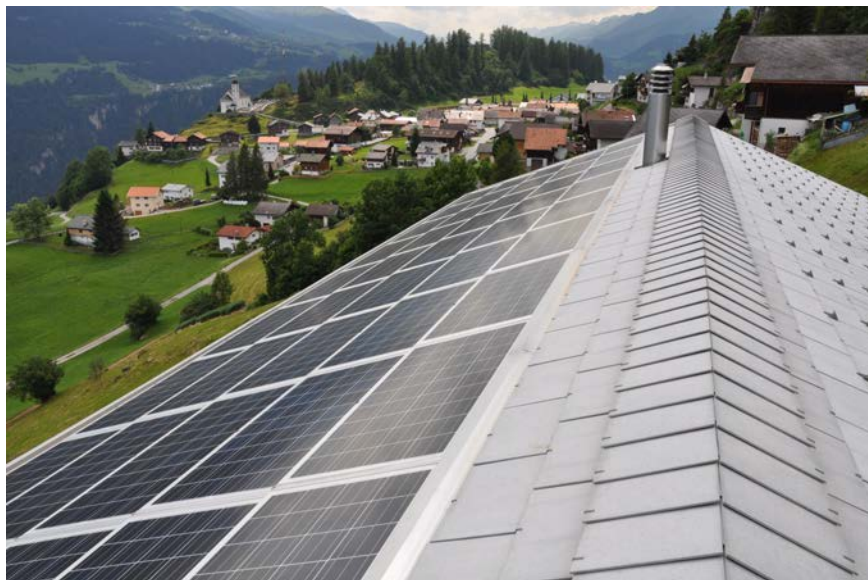
Abbildung 9-2: Wohnhaus, Ruschein. Himmelsrichtung Süd, polykristalline Silizium-Module
