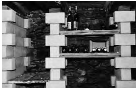
Abb. 151: Trin, Haus Nr. 34. Kalksandstein-Pfeiler als neue Auflager für die Holzbalken- decke im Keller.
