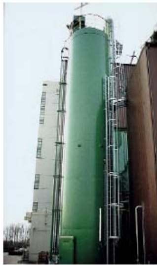
Silobanlage für die Kalkmilchdosierung in Kläranlagen
