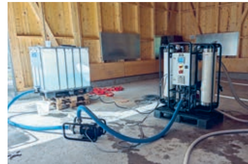
Mobile Aufbereitung von Trinkwasser.
